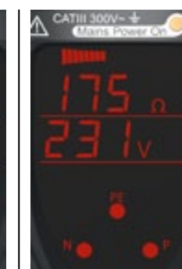
Terre incorrecte (>100Ω)
